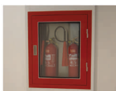
Caixa de hidrantes e extintores
